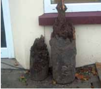
Funderingspalen na langdurige droogstand, draagvermogen 0%.
