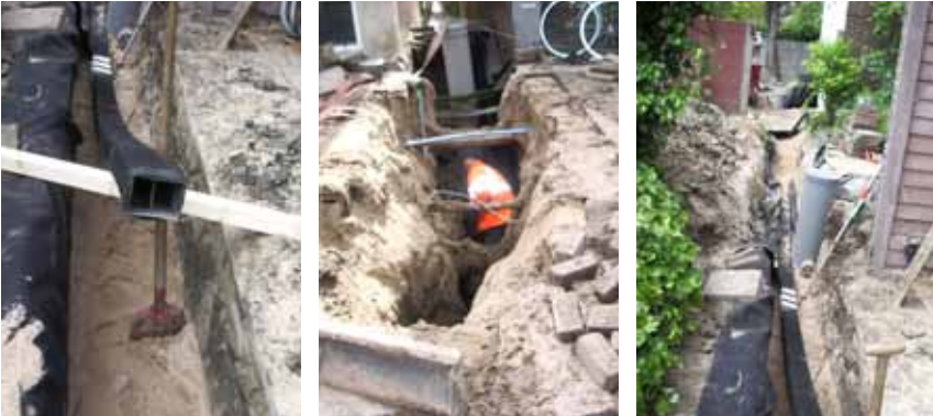
Aanleg infiltratieleiding en scherm in de tuinen van de Krommedijk te Dordrecht
