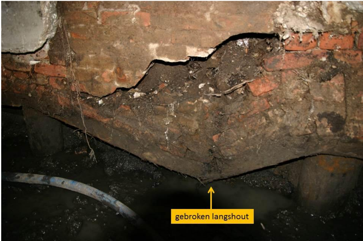
Figuur 1.4 Rotterdamse fundering, gebroken langshout
